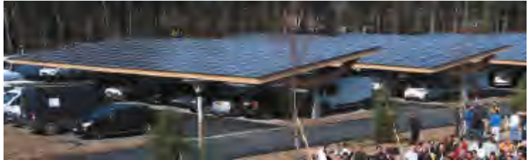
Panneaux photovoltaïques Center Parcs Vienne)
